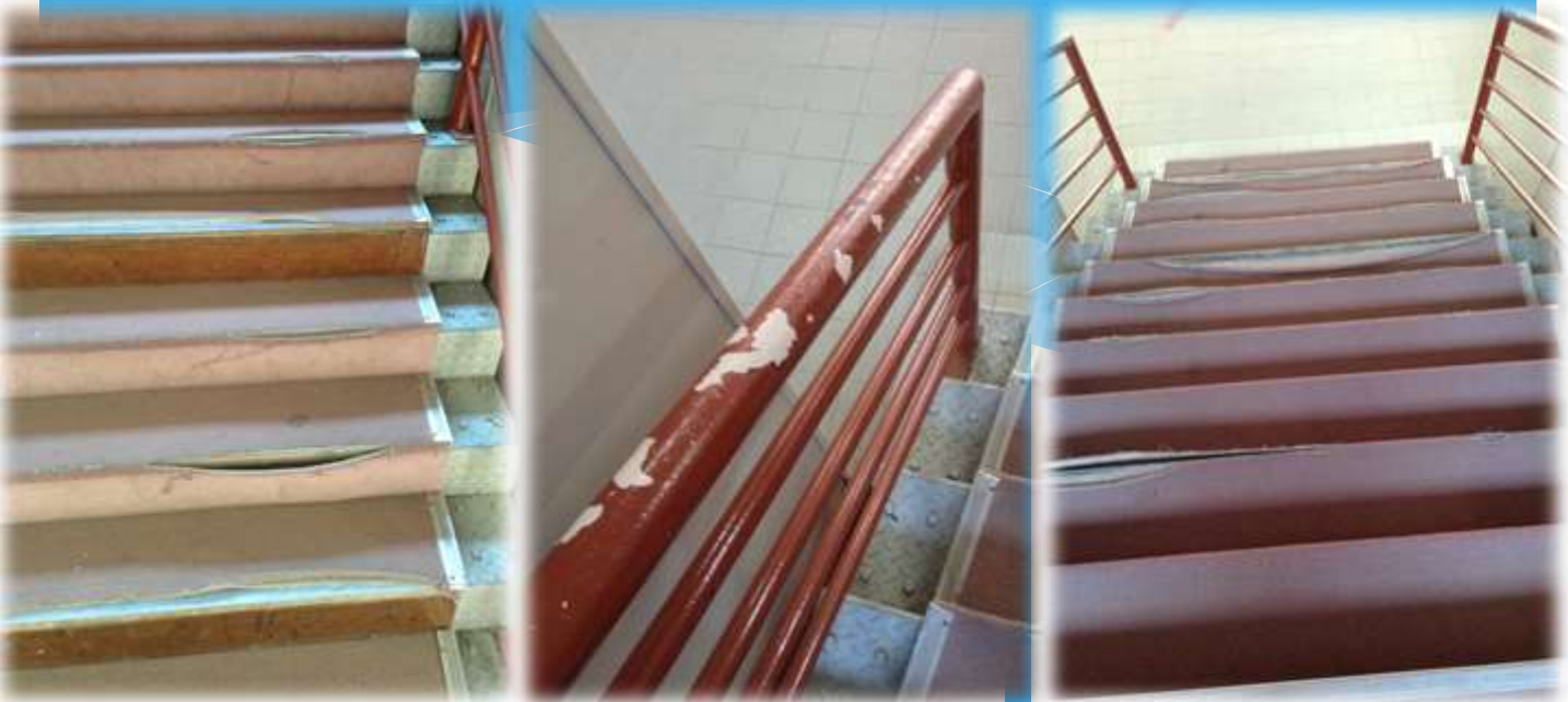
Keadaan karpet di tangga perpustakaan yang memerlukan penggantian
